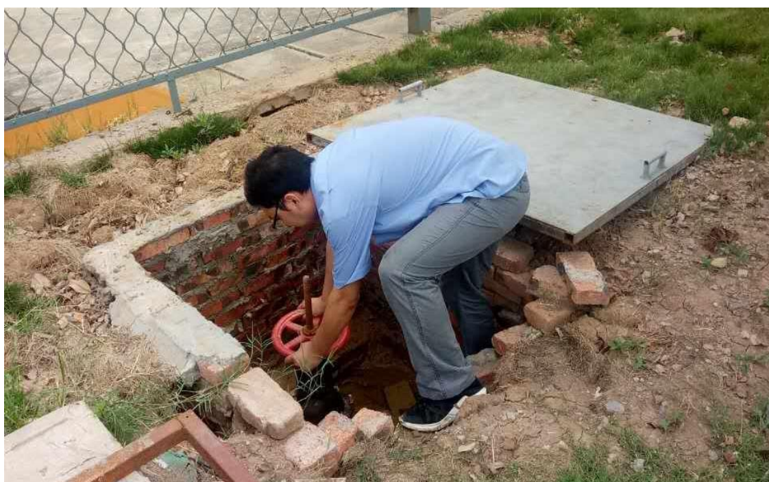
公司环保人员关闭外排口总阀门
